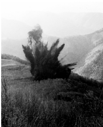
В начале прокладки автотрассы к вершине г. Семиродники применялись взрывные методы. Взрыв горной породы 20.05.1965 г.
